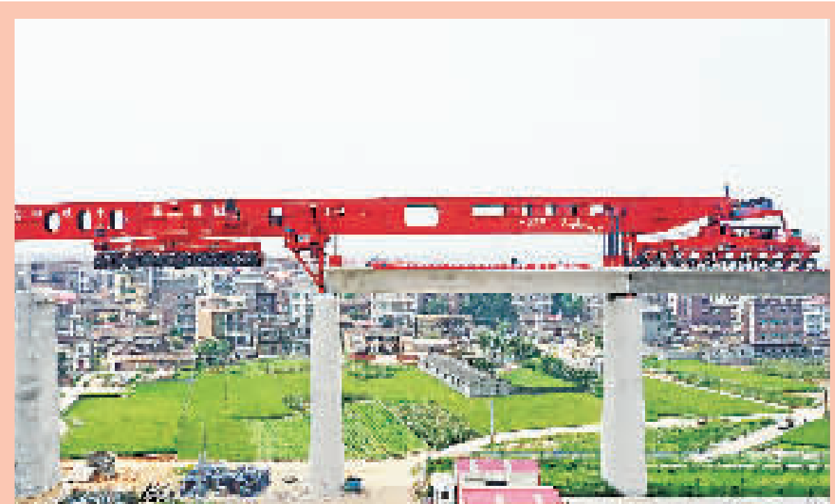
6月22日,中铁十一局集团建设者将一台1000吨箱梁架设在福厦高铁漳州湾跨海大桥上,标志着我国首台1000吨级高铁箱梁架一体机投入使用,我国高铁装备制造和施工水平获得重大突破。
